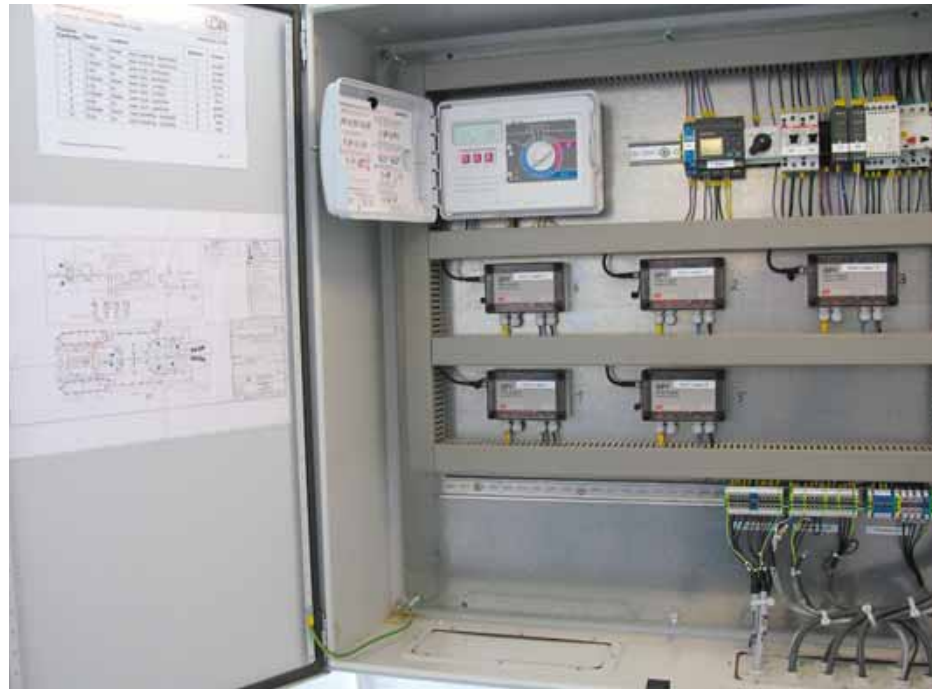
Rain Bird Beregnungsanlage mit ESP Modular Steuergerät. Der Detailplan links unten zeigt die Anlage, aus der Tabelle darüber ersieht der Greenkeeper, wie sich die Kreise auch manuell schalten und entlüften lassen.
