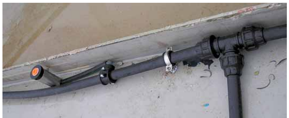
Sämtliche Leitungen, Fittings, Schläuche und Regner der Rain Bird Beregnungsanlage auf dem Golfdeck mussten in einer Schicht von maximal 120 mm untergebracht werden. | Fotos: LGRain.
